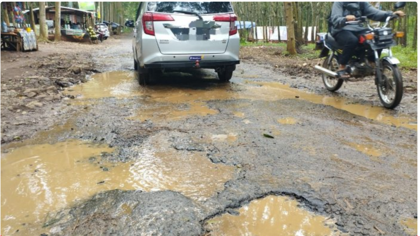
(Foto Istimewa) Kondisi Jalan Yang Rusak Dan Menjadi Keluhan Warga.
